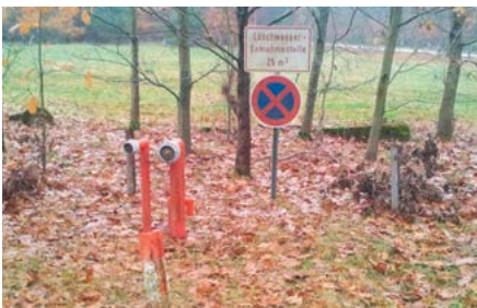
Unterirdischer Löschwasserbehälter mit 25 m 3 Fassungsvermögen und Saugstelle. Foto: A. Lorenz.
